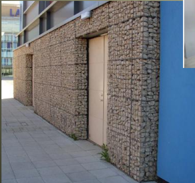
Gavión de Revestimiento.
