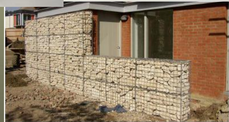
Gavión de Revestimiento.
