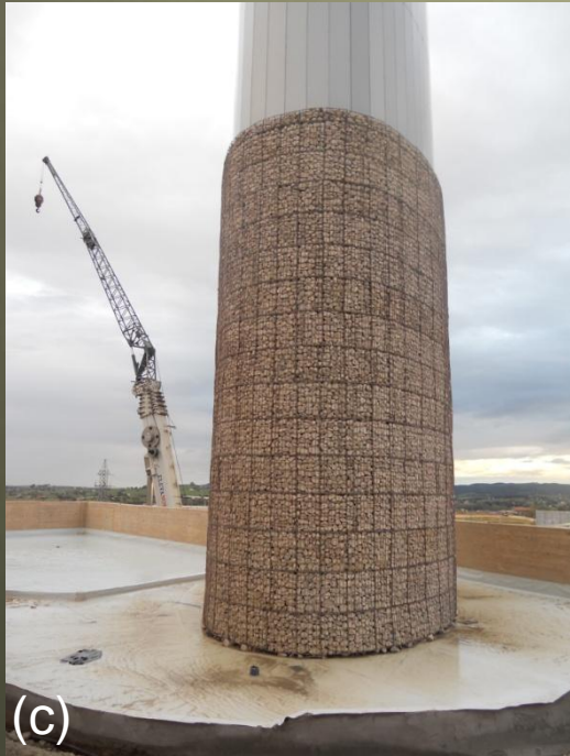
Gavión de Revestimiento.
