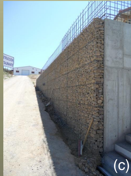
Gavión de Revestimiento.
